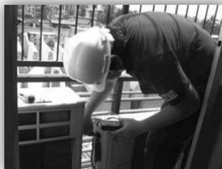
รูปที่ 5.6 แสดงการตรวจวัดค่าพลังไฟฟ้าของเครื่องปรับอากาศ
